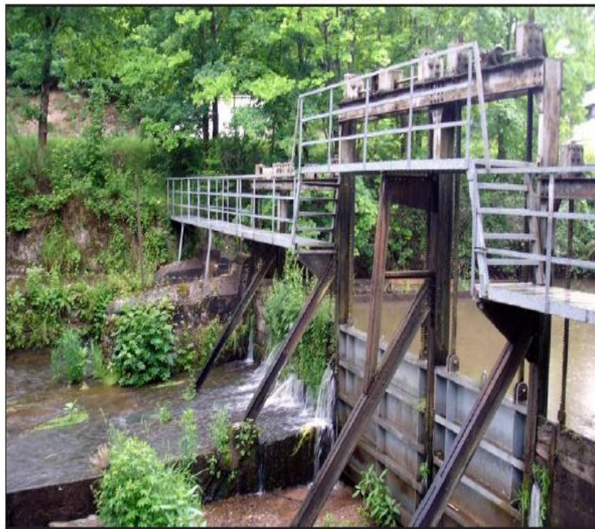
■ De nombreuses installations hydroélectriques existent dans les massifs vosgiens et jurassiens. Souvent, elles doivent cependant être rénovées.
