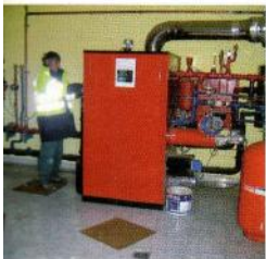
La chaufferie de 80 kW du groupe scolaire et de l'atelier municipal de Fousse-magne.
