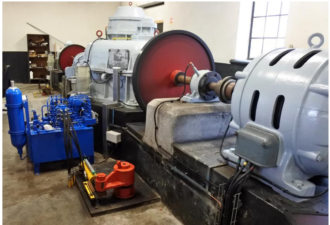
Ercisol a acquis une quatrième centrale hydroélectrique située à Epinal, sur l'ancien site Bragard - ici l'un des 3 groupes turbo-alternateurs.
